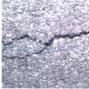
FIGURE 1 – Image de chaussée, de taille 208 \times 208 , dans laquelle on cherche à détecter les fissures.
